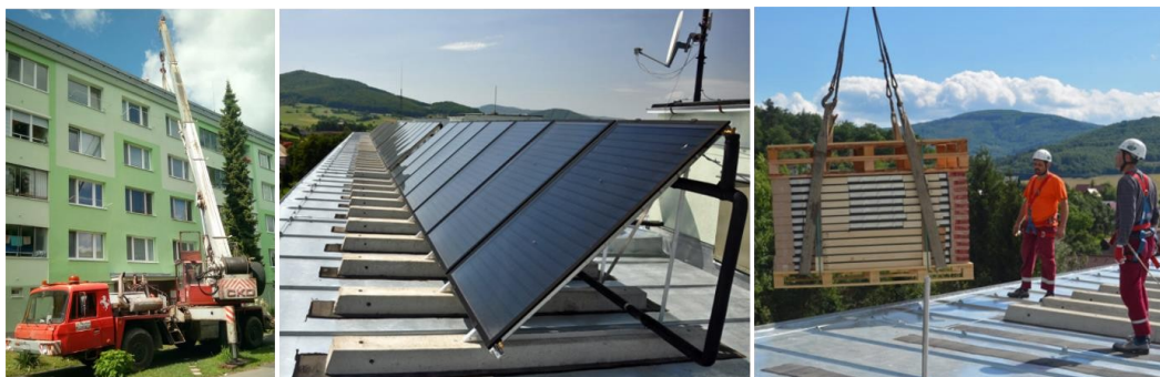
Obrázok 21 Solárny systém na bytovom dome v Detve [29]
