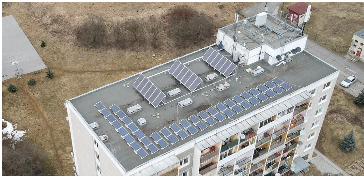
Obrázok 22 Solárny a fotovoltaický systém na bytovom dome v Spišskej Novej Vsi [30]
