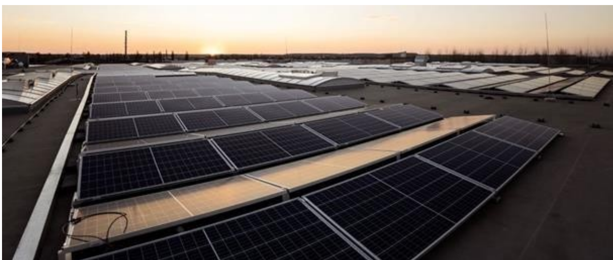
Obrázok 25 Fotovoltaický systém ako lokálny zdroj na streche Hornbachu v Nitre [33]
